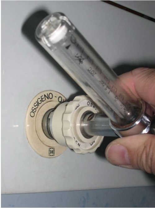
FIG. 29 INNESTO DI UN FLUSSIMETRO AD UNA PRESA ( AFNOR) DI OSSIGENO MEDICINALE (AIR LIQUIDE SANITA)
