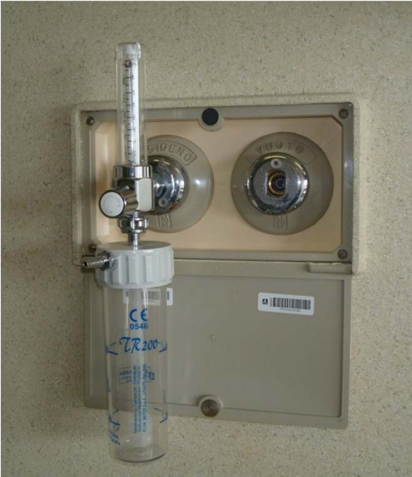
FIG. 29 FLUSSIMETRO / UMIDIFICATORE COLLEGATO AD UNA PRESA DI EROGAZIONE (TIPO UNI)
