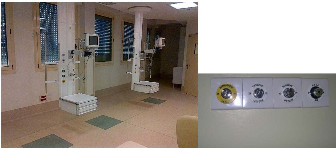
FIG. 14 PRESE DI EROGAZIONE GAS MEDICINALI SU PENSILI E A MURO
